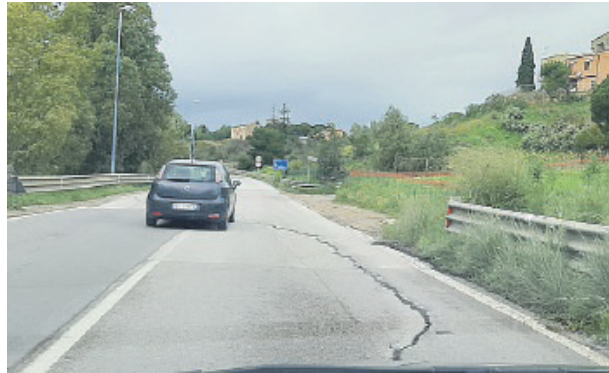
Il tratto della strada statale 115 interessato dalla frana
